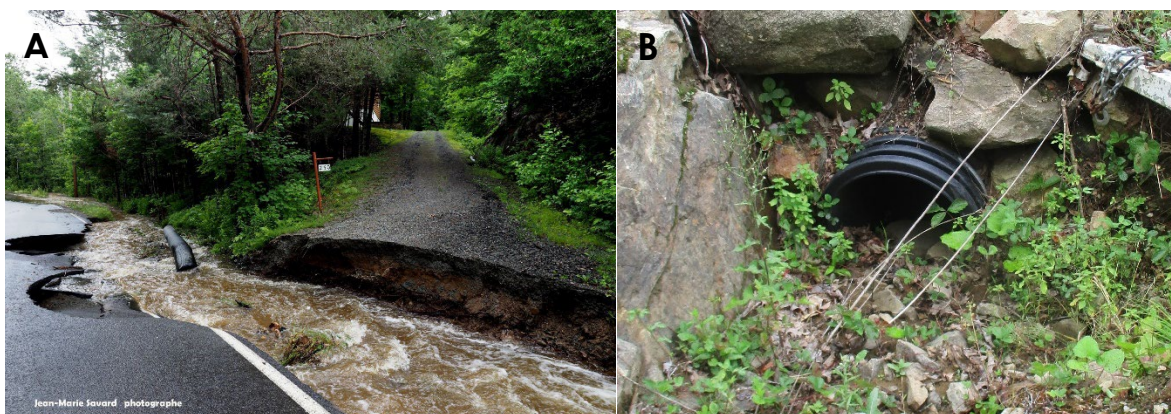
Figure 14–1. Exemples de A) ponceau et route emportés suite aux précipitations historiques de juin 2021* et B) ponceau partiellement obstrué par les sédiments
